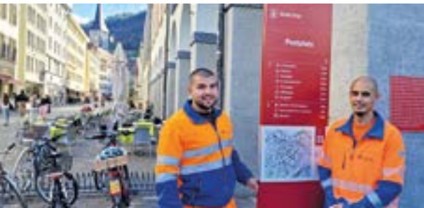
Mitarbeiter der Firma Signal AG montieren die neue Informations-Stele an der Poststrasse.
